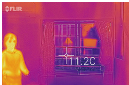
寒い家のサーモグラフィ画像。窓の温度は11℃。窓から熱が逃げている様子がわかります。
