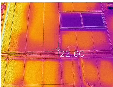
【画像2】窓枠から雨水の漏れが疑われる温度の下がった部位があります。
